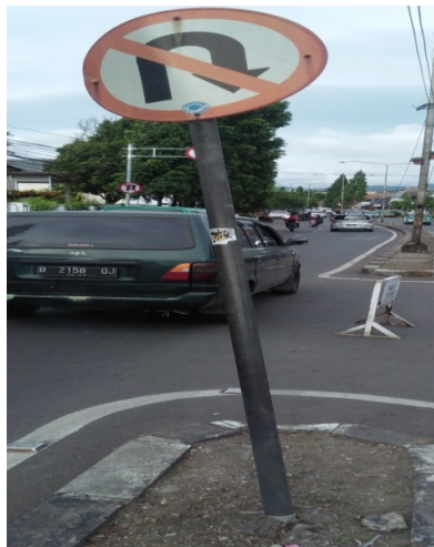
Gambar 3 Kondisi Tiang Rambu Sumber : Dokumentasi Pribadi, 2019
