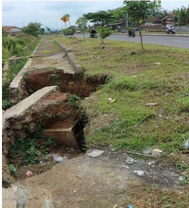
Gambar 4 Kondisi Trotoar Sumber: Dokumentasi pribadi
