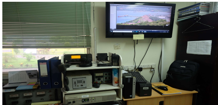
Gambar 7. Fasilitas komunikasi dan navigasi Bandar Udara Khusus Perairan Benete
