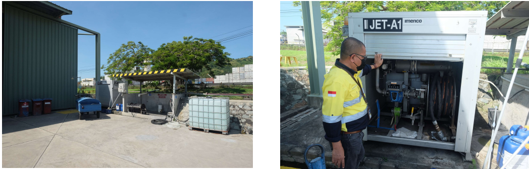
Gambar 10. Tempat penyimpanan fuel Bandar Udara Khusus Perairan Benete
