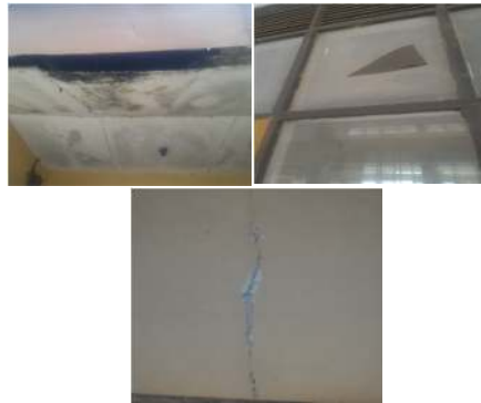
Gambar 2. Bangunan rusak di UPT BLK
