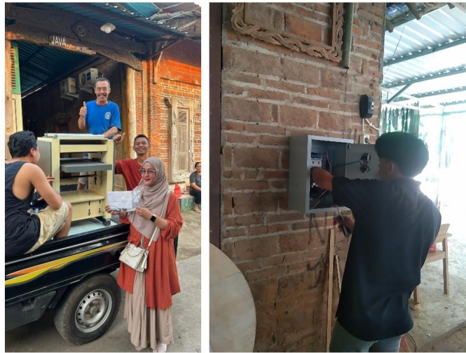
Gambar 3. Proses Penerapan Teknologi Sistem Kendali Kecepatan Motor berbasis IoT
