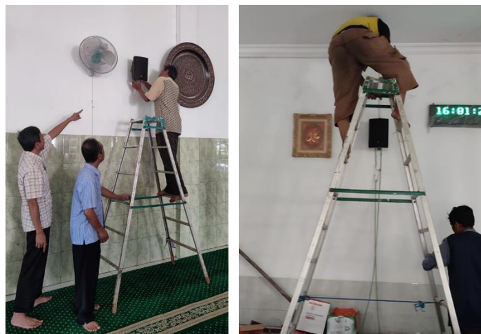
Gambar 8. Instalasi sistem audio
